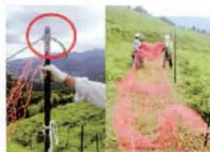
⑤ 布設開始 ネットの一端を支柱にロープの端で固定し、もう一端側のネットを引っ張って広げます。
